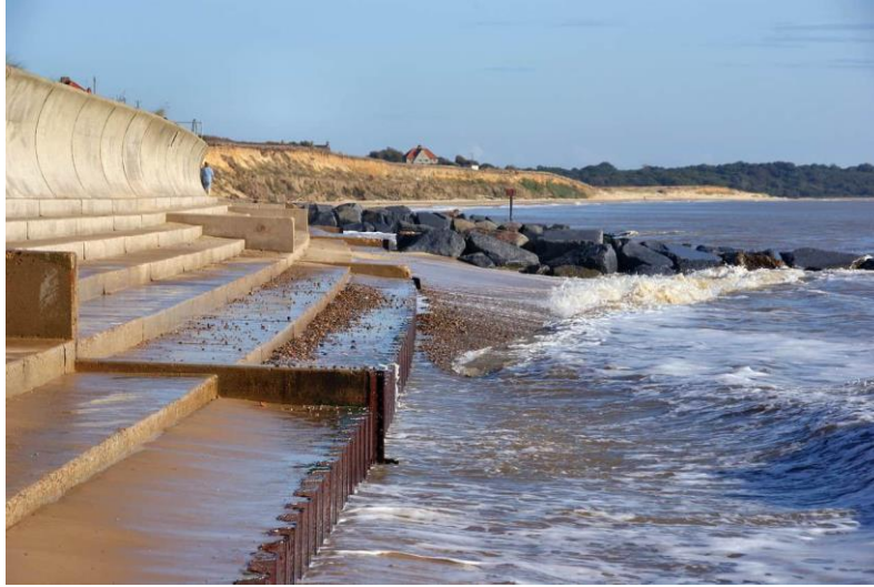
Şekil 13-34 Deniz Kıyısındaki Yollara Özg Koruyucu Bariyer Örneđi (Coastal Protection Structures, 2022)
